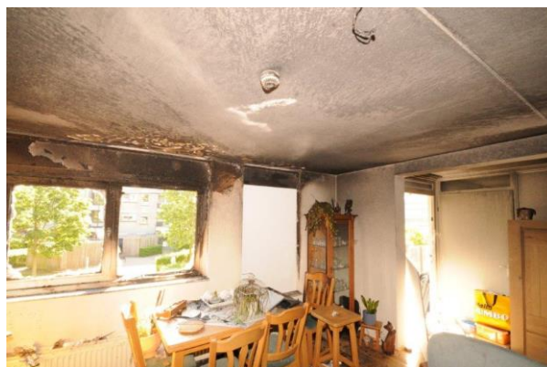
Foto 8: Brandwoning 1 e verdieping
