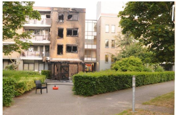
Foto 2: Gevel met uitgebrande scootmobielstallingen
