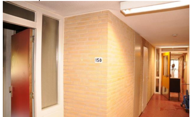
Foto 7: Rookverspreiding gang. 158 brandwoning
