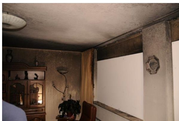
Foto 10: Brandwoning 2 e verdieping
